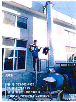
图 2: DA002 有组织废气排放口监测点
